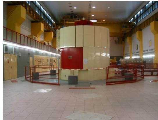
HPP Dlouhé Stráně 2x325 MW
