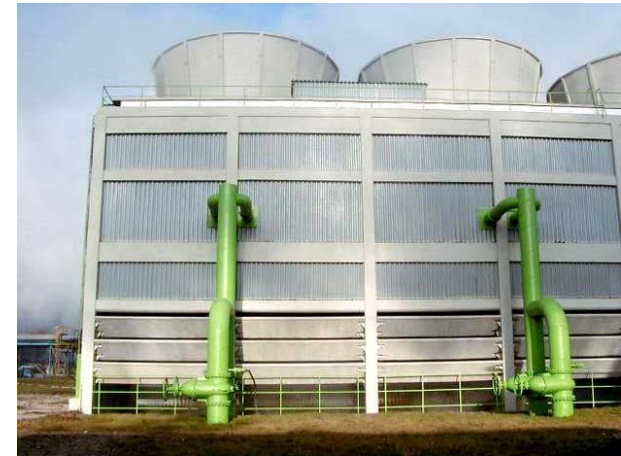
ventilátorová chladicí věž (Elektrárna Opatovice)
