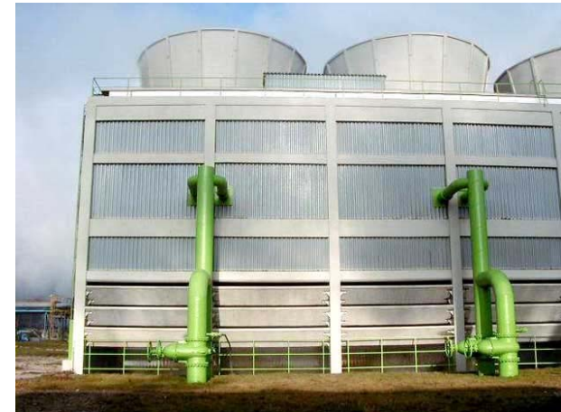
ventilátorová chladicí věž (Elektrárna Opatovice)
