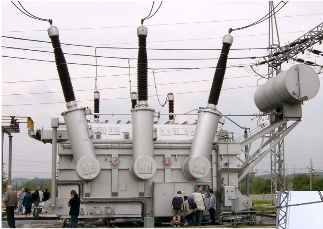
350 MVA, 400/110 kV YNauto - d1, Sokolnice
